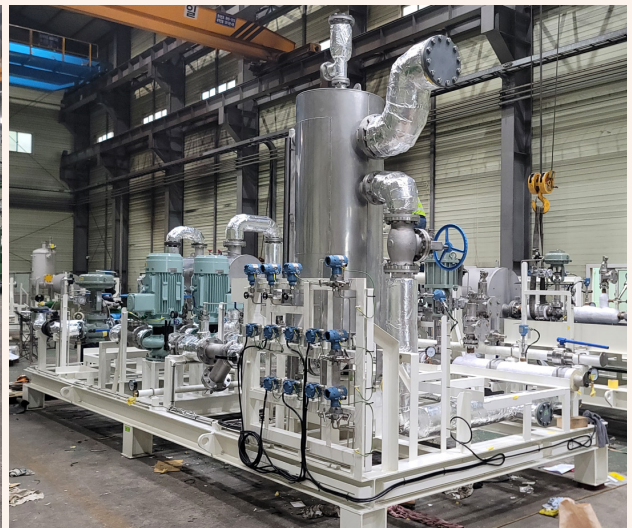
LNG Glycol Water Skid
